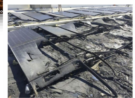
Walmart PV array fire (2019)
